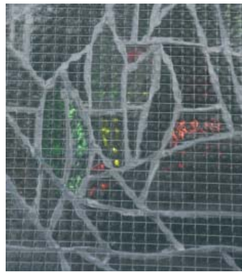
12. kép. A rossz megoldást máig használják. A drótbetétes üveg torzításai a külső oldalról. Budapest, Városmajori templom.
