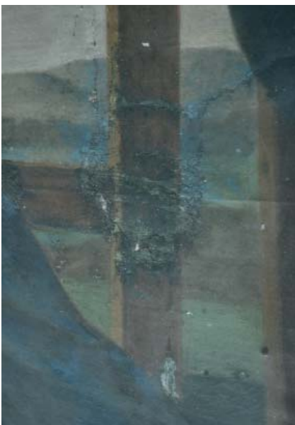
3. kép. Régi kiegészítés átnyomódása a színoldalra.
