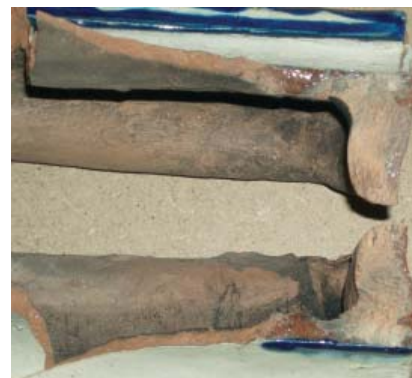
39. kép. Készítéstechnikai hiba, repedés.
