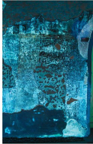
4. kép. Az északi fal alsó szakasza, lumineszcens felvétel: az alsó, sötétben jelentkező kiegészítő vakolaton a sókivirágzások az UV gerjesztés hatására világosan jelennek meg.
